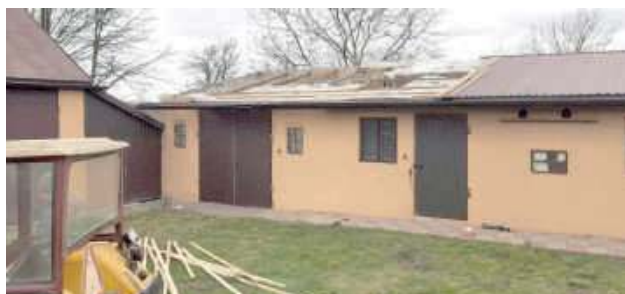
Uszkodzony został dach na budynku gospodarczym w Sosnówce w gminie Abramów
