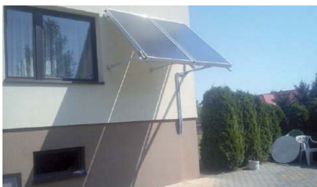
Gmina pozyskała dofinansowanie na montaż odnawialnych źródeł energii dla mieszkańców.
