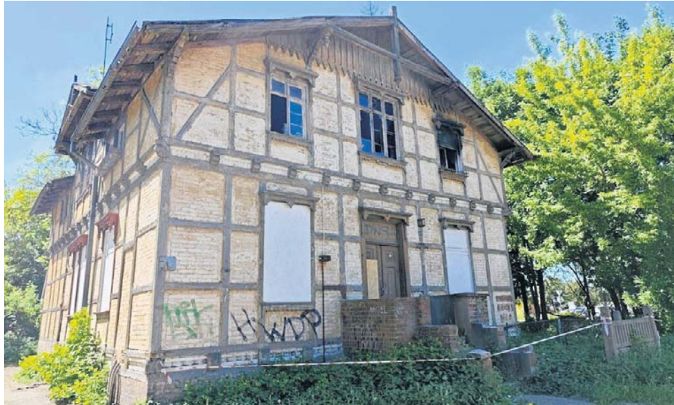
Tak wygląda budynek przy ulicy Dybowskiej 15 dwa tygodnie po pożarze
