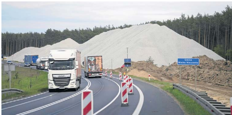
Budowa fragmentu trasy S10, będącego południową obwodnicą Torunia, rozpoczęła z opóźnieniem się na początku kwietnia tego roku
