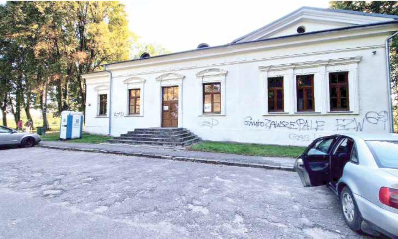
Wandale zniszczyli odrestaurowaną elewację sprayem. Kolej obiecuje, że usunie napisy i oświetli nieruchomość
