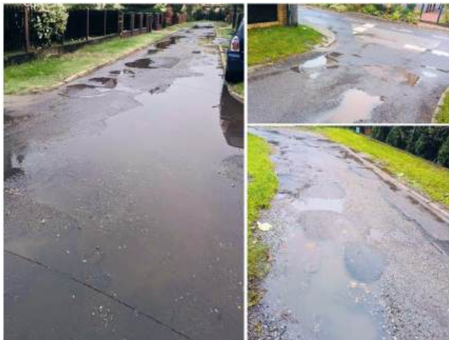
Tak wygląda nawierzchnia ulicy Ignacego Kraszewskiego w Chełmie po opadach deszczu. Liczne ubytki w jezdni wypełniają się wodą, przez co trudno ocenić ich głębokość. Miasto zapowiada doraźne naprawy do 20 listopada, a kompleksową przebudowę ulicy planuje na 2027 rok.
