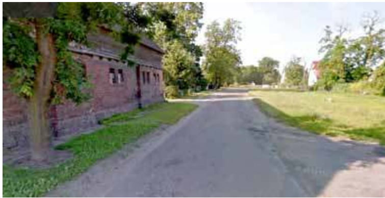
Droga w miejscowości Kunowo od lat wymaga remontu
