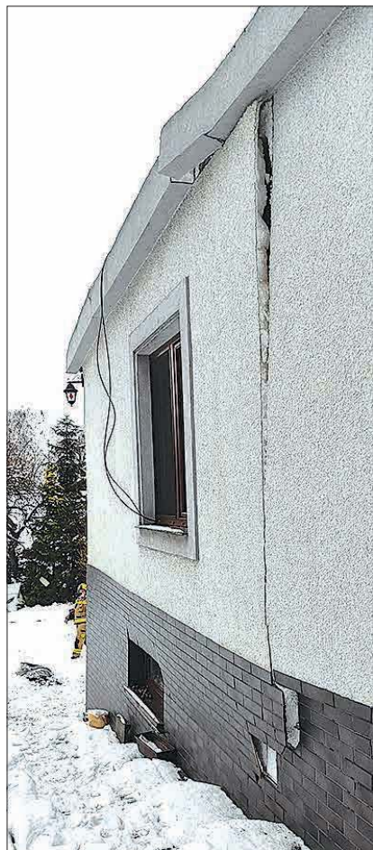
Wybuch naruszył konstrukcję budynku
