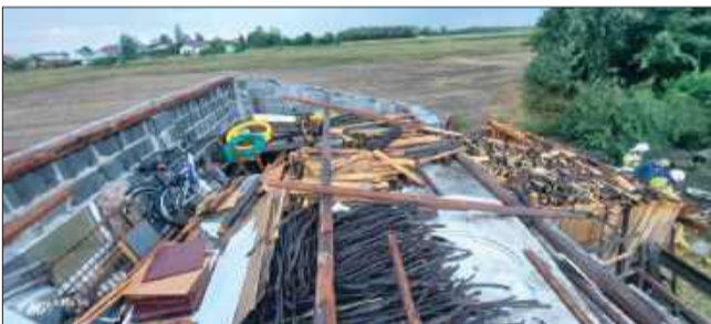
Silny wiatr zerwał dach z budynku gospodarczego.
