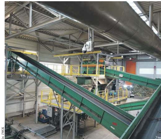
W środku biogazowni
