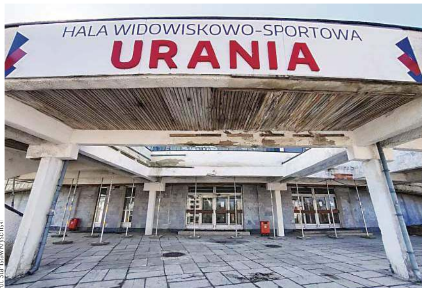
Urania naprawdę potrzebuje remontu
