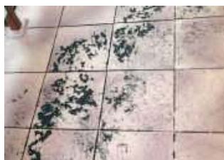
Już w ubiegłym roku mieszkańcy zmagali się ze smolistymi zanieczyszczeniami. W tym roku problem nasilił się. Oblepiane są płytki terakotowe, okna, samochody zaparkowane przed domami
