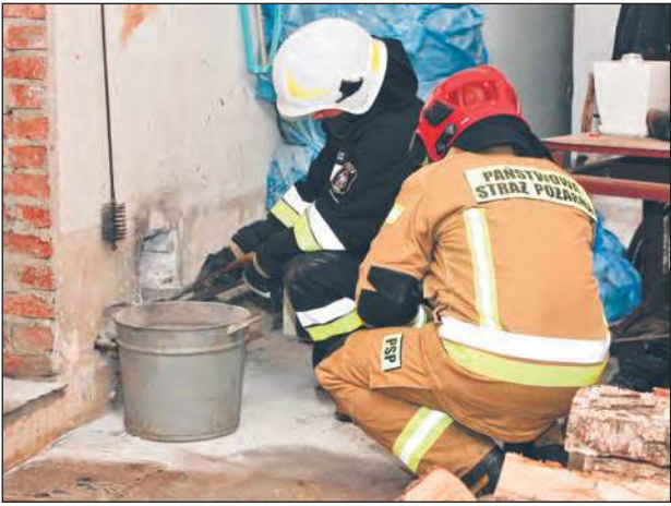
Strażacy przypominają o konieczności regularnych przeglądów stanu technicznego przewodów kominowych. W przypadku nagromadzenia sadzy należy ją bezzwłocznie usunąć, aby uniknąć ryzyka pożaru (fot. archiwum TG)
