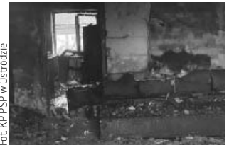
Zniszczony w pożarze dom trzeba zabezpieczyć przed zimą
