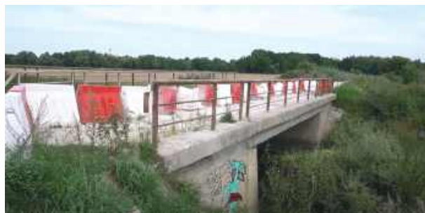
Most w Białym Kościele został uszkodzony podczas powodzi w 2024 roku. Teraz ma być odbudowany
