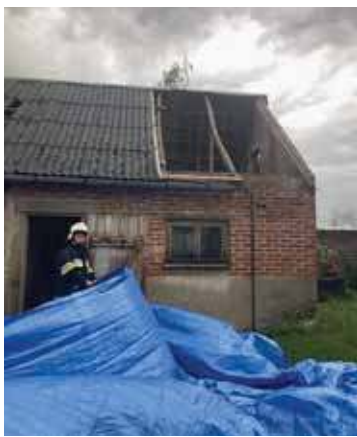
Zerwany dach na stodołę w Szwelicach
