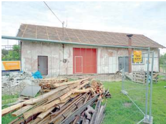
Tak przed kilkunastoma dniami wyglądał budynek wiejskiej świetlicy w Starym Orzechowie
