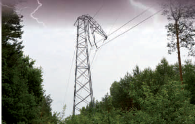
DĄBROWA WRONOWSKA. Słupy połamane są jak zapalki. Silnemu wiatrowi nie była w stanie oprzeć się nawet linia wysokiego napięcia
