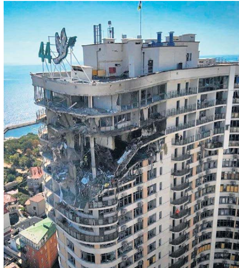
Rosjanie atakowali Odessę w nocy z soboty na niedzielę. Uszkodzono m.in. placówkę edukacyjną i wielopiętrowy budynek
