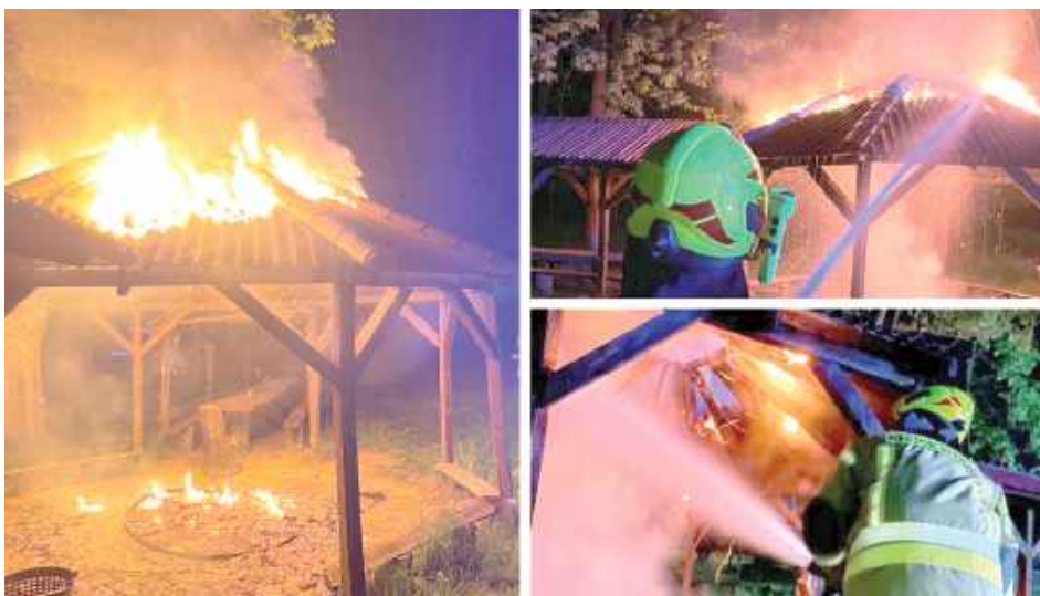
W wyniku pożaru zniszczeniu uległo pokrycie dachowe oraz więźba dachowa obiektu (fot. OSP - KSRG Stężyca)
