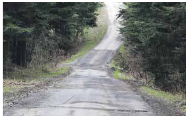
Największe dziury pozostały na najbardziej stromych odcinkach drogi.
