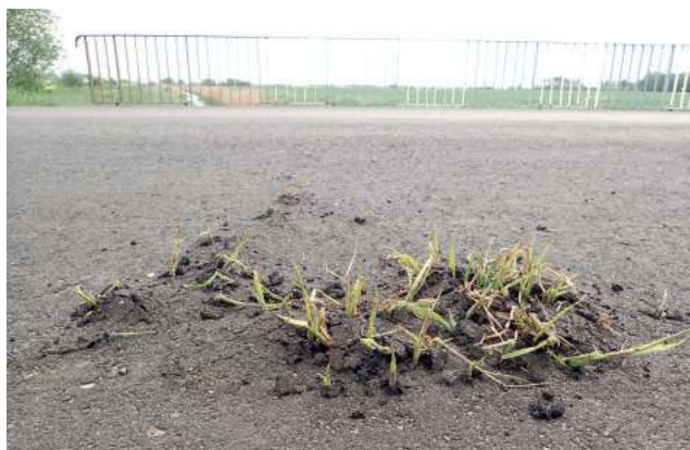
Roślinność wyrasta spod asfaltu położonego na moście na rzece Zielawa. Zdjęcie zrobione 7 maja 2019 roku
