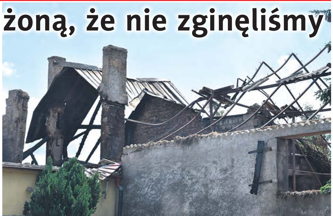
Kompletnemu spaleniu uległo poddasze budynku i strych znajdujący się nad częścią mieszkalną.
