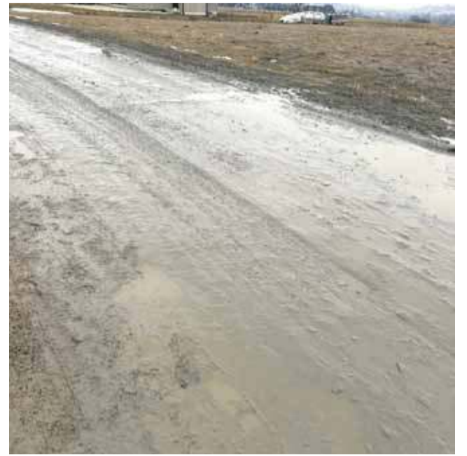
Wójt Roman Krupa zapewnia, że niebawem opracowana zostanie dokumentacja remontowa.
