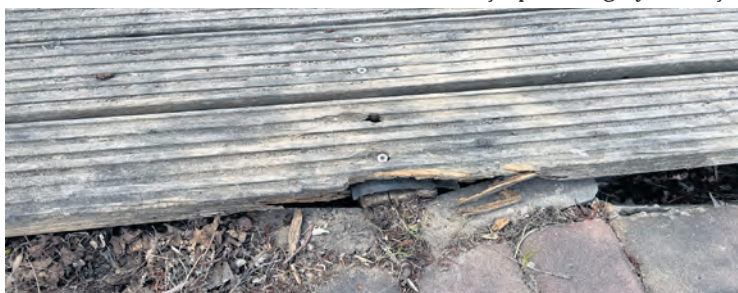
Przeгляд pomostów został już przeprowadzony. Wójt gminy zapowiada wymianę spróchniałych lub uszkodzonych desek.
