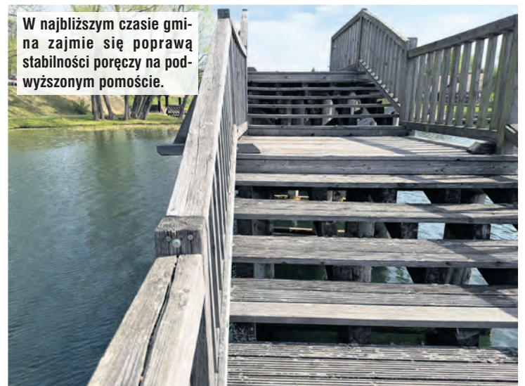
Na niektórych fragmentach pomostów i balustrad widać już nowsze elementy metalowe.
