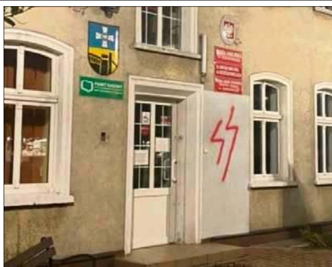
Nieznany sprawca znów zniszczył elewację.
