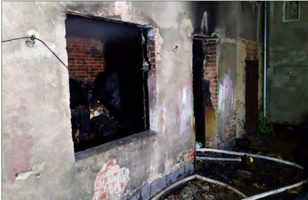
Budynek nie nadaje się do zamieszkania.
