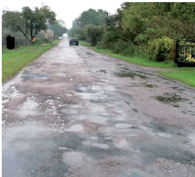
Popękana i łamana - tak wygląda obecnie droga powiatowa w Leoninie. Mieszkańcy skarżą się na uciążliwe dziury, które co rusz pojawiają się w nawierzchni
