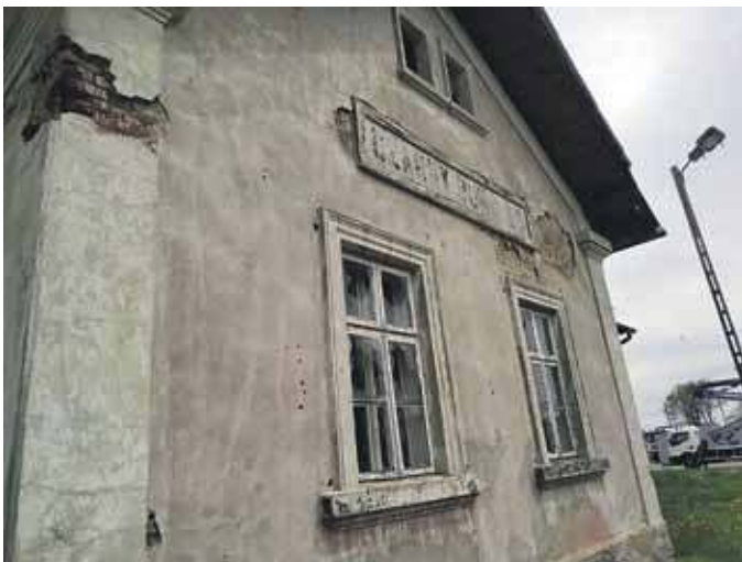
Dawna stacja kolejowa Czarny Dunajec. Powybijane okna, zniszczona elewacja. Budynek robi ponure wrażenie.
