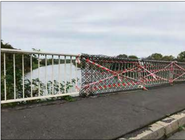
Uszkodzone bariery na krapkowickim moście.
