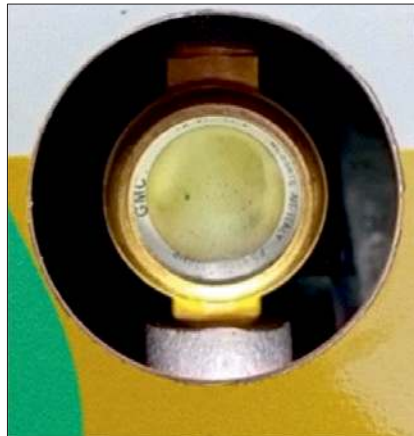
Rys. 2. Widok zabrudzonego czynnika chłodniczego w obiegu maszyny do płukania podczas procesu usuwania zanieczyszczeń z instalacji
