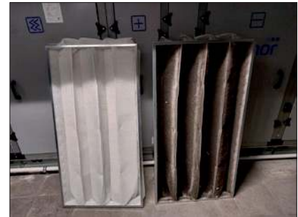
Fot. 4. Porównanie stanu filtra kieszeniowego z centrali wentylacyjnej przed i po eksploatacji Źródło: archiwum autorki
