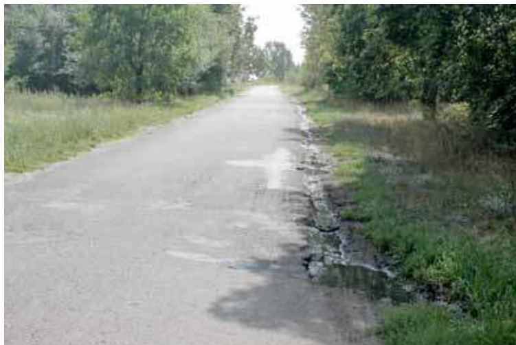
Płynąca wzdłuż pobocza drogi stróżka ścieków wypływających z przepełnionej studzienki.
