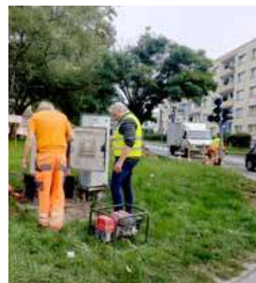
Wymianie ulegnie widoczna część sygnalizacji, a także oprogramowanie urządzenia - sterowniki
