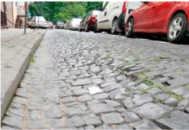
Na ul. Czystej nadal będzie można uszkodzić podwozie auta
