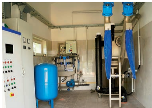
„Serce” zmodernizowanej oczyszczalni
