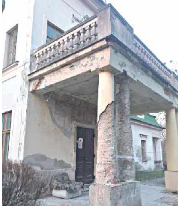
Aktualny wygląd dworku - dla wielu niemożliwym byłoby mieszkanie w budynku. Wyobraźmy sobie, jak mieszkańcy spędzili zimę...
