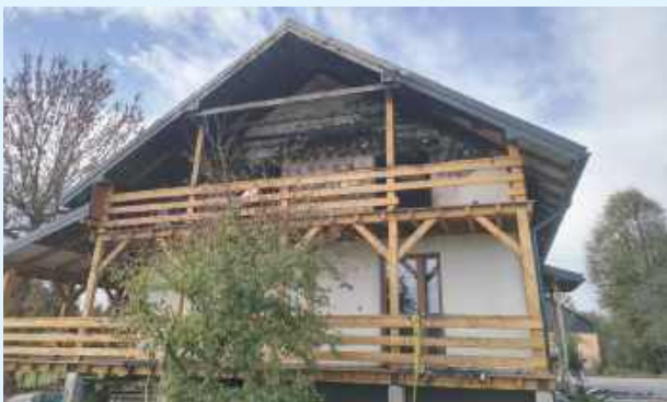
W Białobrzegach całkowitemu spaleni uległo poddasze domu wraz z więźbą dachową
