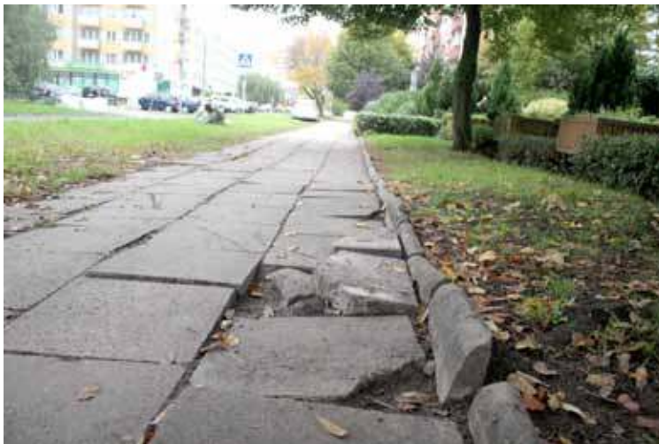
Chodniki na ul. Czeskiej wymagają naprawy
