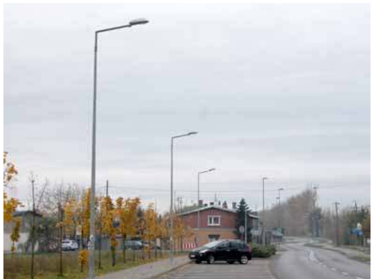
Lampy na Spokojnej nie działały po zmroku powodując niebezpieczną sytuację. Na szczęście problem został zażegnany
