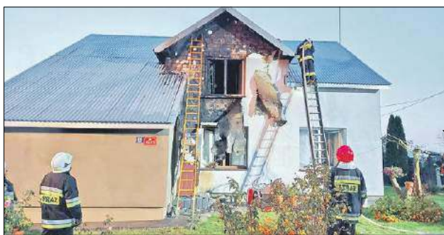
Zniszczeniu uległy trzy pomieszczenia, częściowo elewacja budynku i dach
