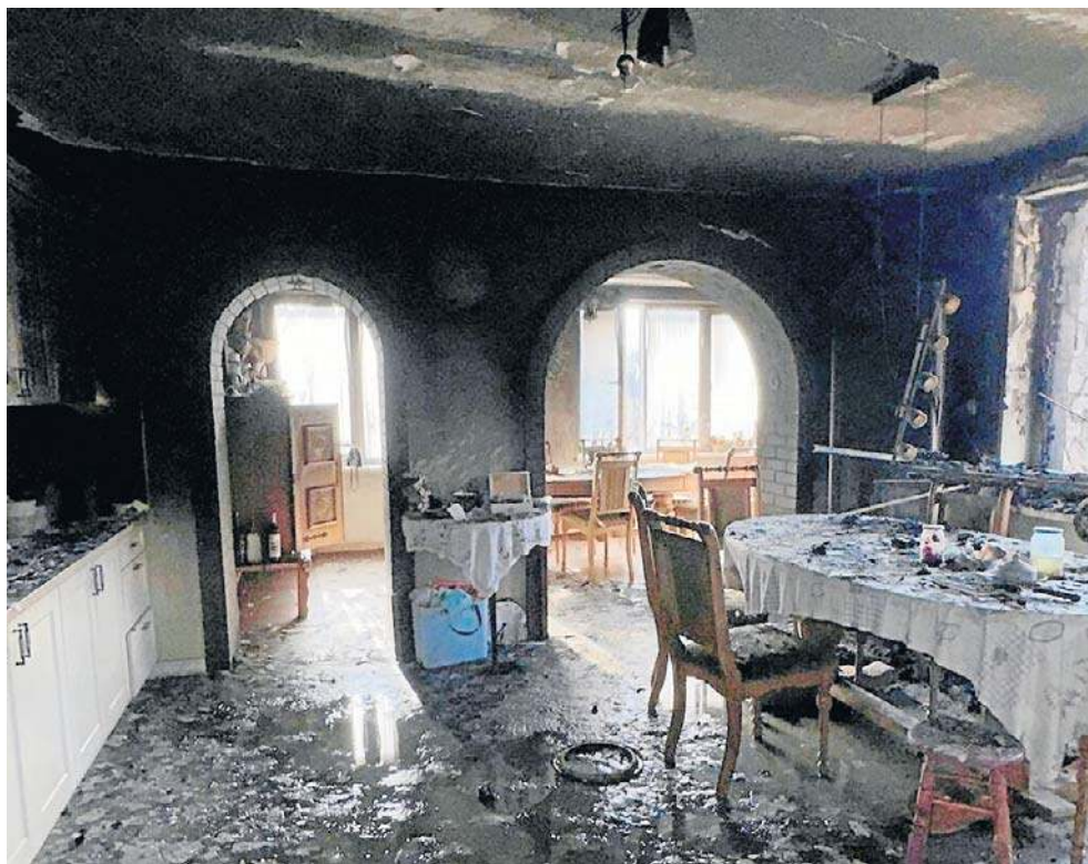
Gaszenie pożaru trwało kilka godzin. Potem strażacy przystąpili do prac rozbiórkowych
