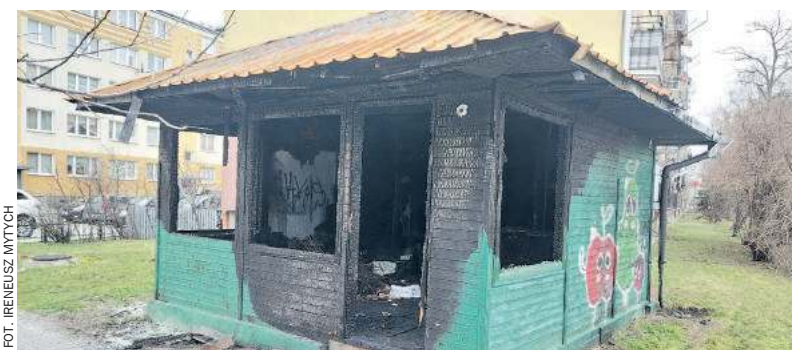
Nadpalony kiosk znajduje się przy ulicy osiedlowej Aleje Jana Pawła II przy bocznej ścianie bloku mieszkalnego nr 2
