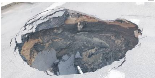
Maciej Łyko: Ta dziura jest znacznie większa od tej sprzed kilku lat, gdy zapadła się część jezdni przy chodniku na Placu Wolności.
