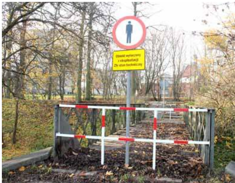
Kładka łącząca Aleję Spacerową z ul. Marii Skłodowskiej-Curie, z powodu złego stanu technicznego, pozostaje zamknięta
