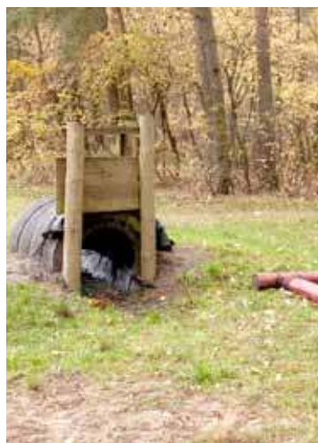
Zdewastowano urządzenia służące do wypoczynku i edukacji
