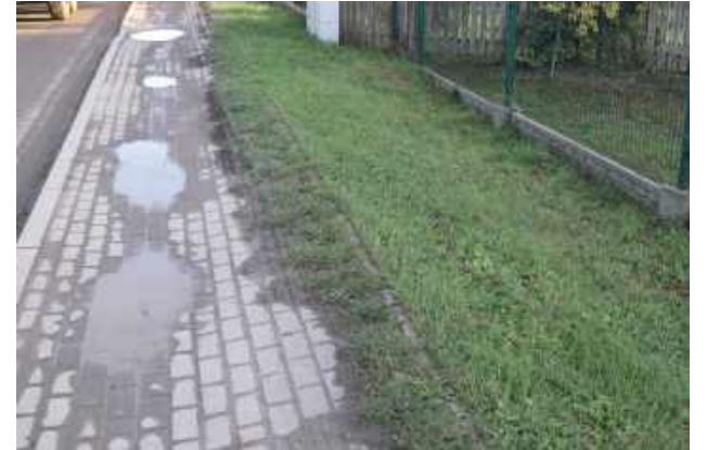
Chodnik w Annoborze zapadł się - według radnego Łukasza Żmudy stało się to przez ruch ciężarówek z budowy
