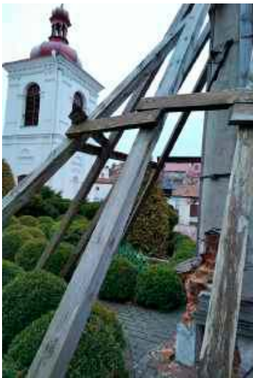
Kolumnę przed runięciem chronią prowizoryczne podpory. Stojąca kiedyś na niej sama figura Matki Boskiej od czterech lat czeka schowana w dzwonnicy
