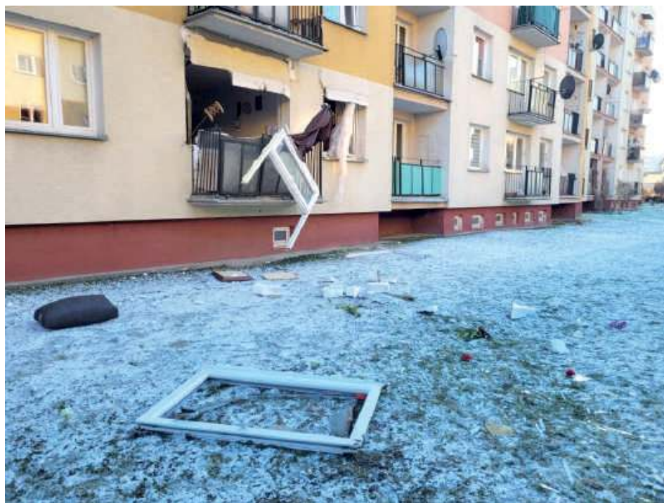
Siła wybuchu była tak duża, że okna i ściany zostały mocno uszkodzone
