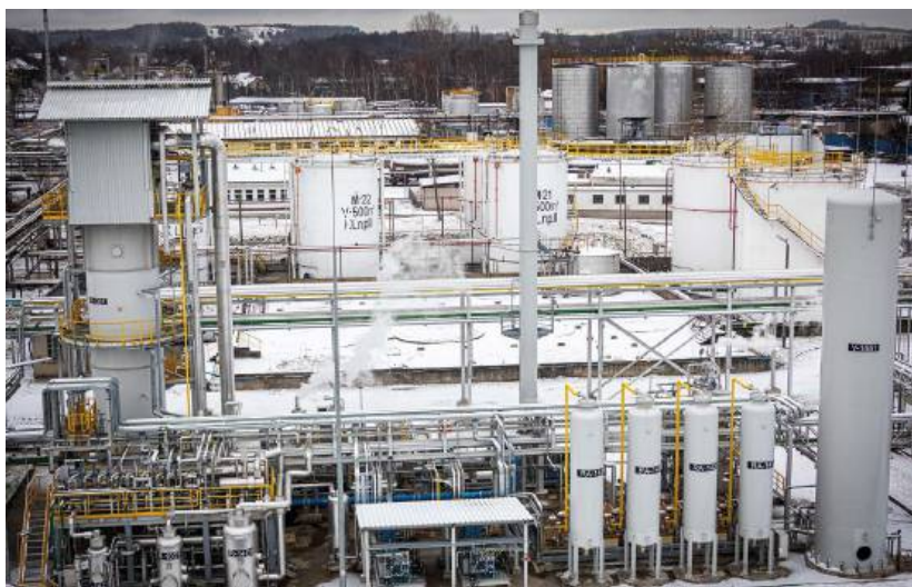
Wytwórnia wodoru. Trzebinia.
