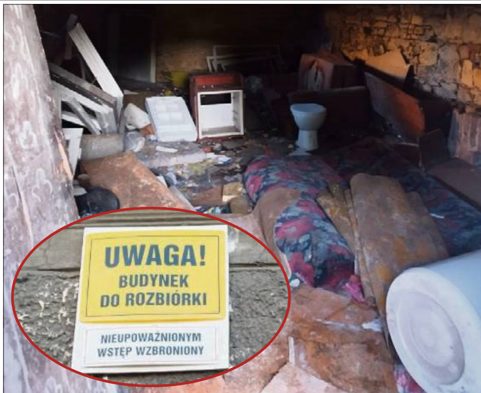
Budynek przeznaczony jest do rozbiórki.
