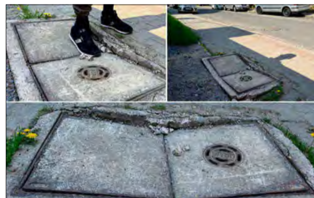
Zapadająca się studzienka na ul. Głębokiej w Krapkowicach stanowi zagrożenie.
