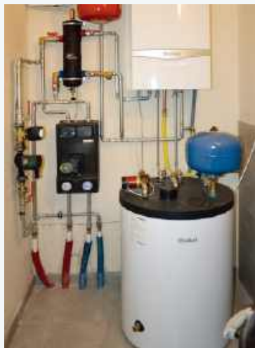
Przy markowym wiszącym kotle kondensacyjnym zamontowano stojący zasobnik 120 l.
