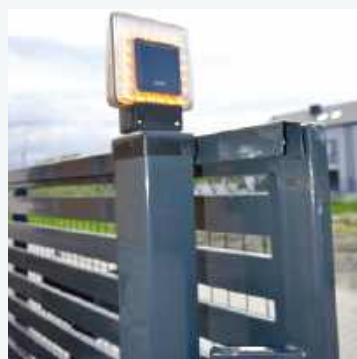
🔧 W trakcie 8 lat użytkowania, na ramie skrzydła powstały drobne uszkodzenia lakieru, ocynku, pojawiła się rdza.
