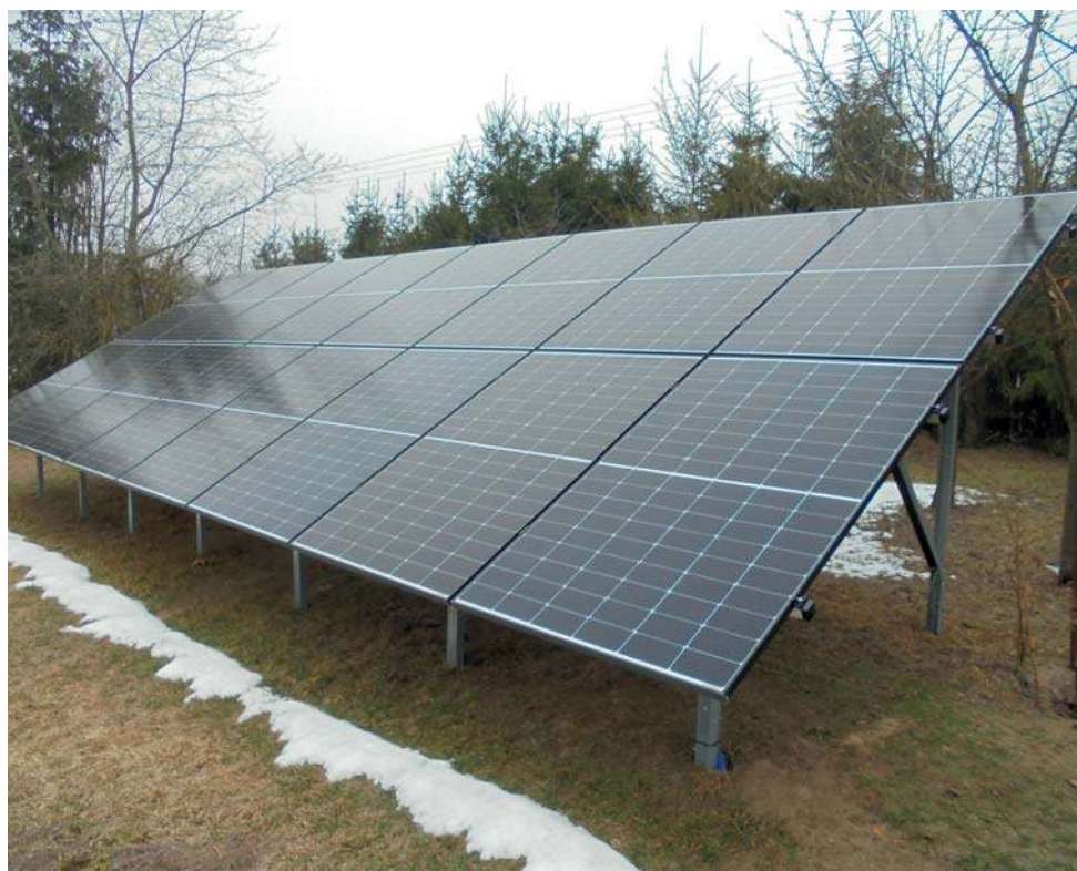
Panele fotowoltaiczne dofinansowane z Programu Czyste Powietrze
