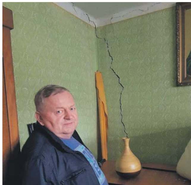
Spekana ściana w pokoju przedwojennego domu pana Stefana
