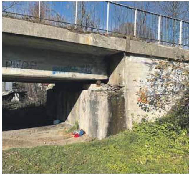
Most w Ludźmierzu jest w katastrofalnym stanie technicznym.
